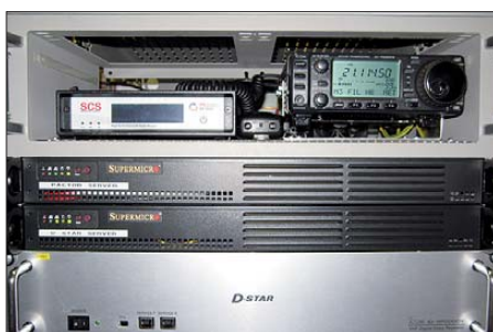
Eine Augenweide: Blick auf die nach professionellen Standards gebaute Pactor-Station
