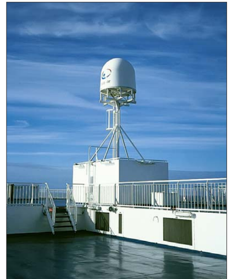
Von hier aus gehts nach oben ins Weltall – die Inmarsat-Antenne auf der Fähre Norröna
