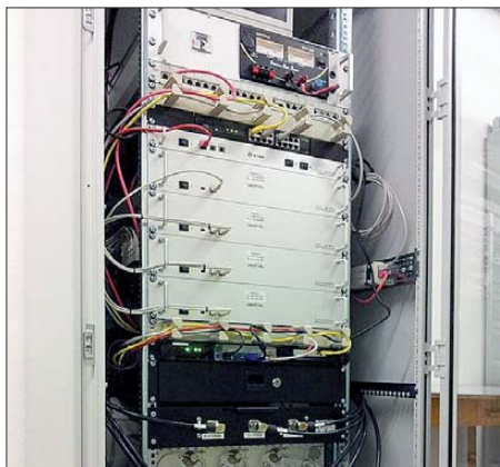
Blick in den DB0ESS-Technikschrank Foto: DB0ESS
