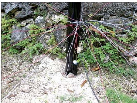
Das Radialnetz der 80-m-Vertikal mit Spule zur besseren statischen Ableitung
