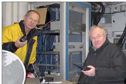
Norbert, OE1NDB (l.), und Kurt, OE1KBC, bei der Installation der Technik von OE1XQU am Wienerberg Foto: OE1KBC
